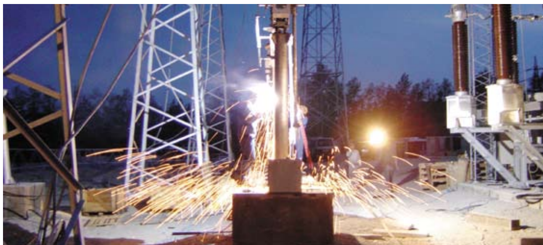
Подстанция 220 кВ Благовещенская – один из объектов ФСК, где работали специалисты Гидроэлектромонтажа.
